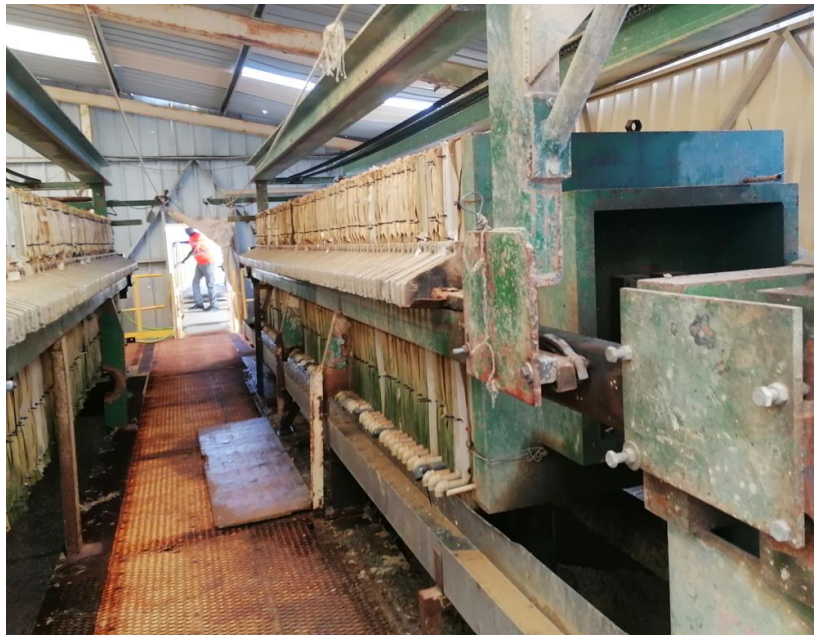
Figura 8 – Filtroprensagem. Fonte: visita 22-07-2026
