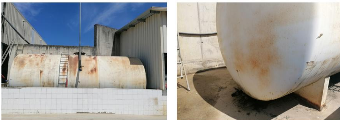
Figura 12 – Depósito de Gasóleo e bacia de retenção. Fonte: visita 22-07-2026
